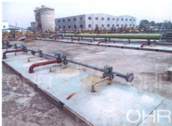
↑某知名企业煤化工废水扩建项目。处理水量9100m 3 /D，池顶水泥盖板，2015年运行至今免维护。
