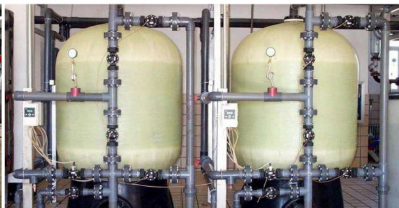
小水量罐体式, 单罐处理200m³/d
